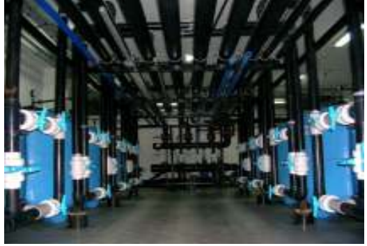
Pompa ve filtreler dairesi
